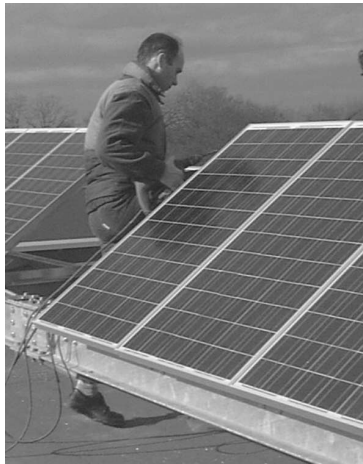
(a) montage de panneaux ASE 100 W silicium polycristallin
