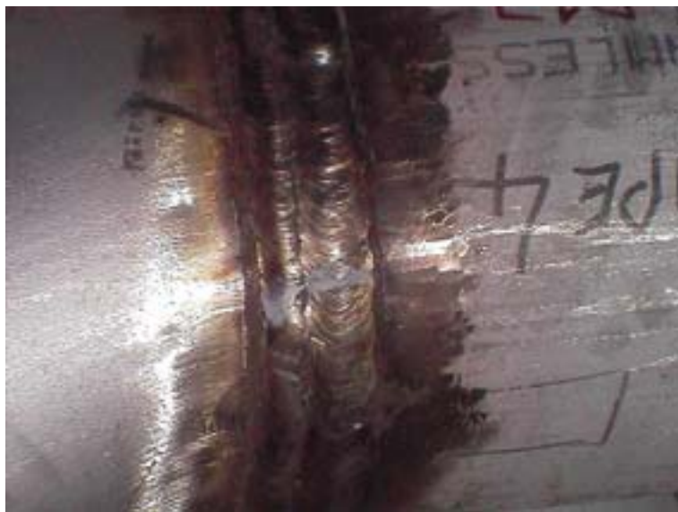
La pièce en acier soudée lors du soudage : la couche d'oxyde peut favoriser la corrosion si elle n'est pas supprimée correctement.
